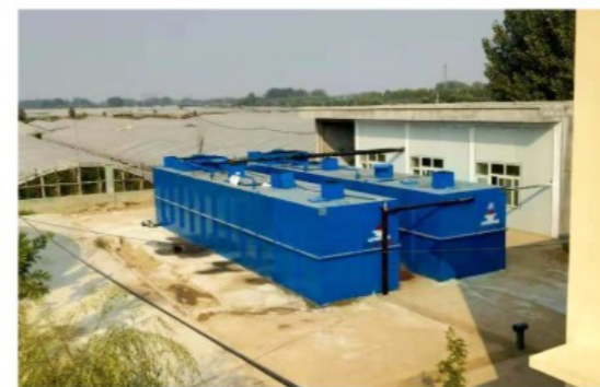
聊城生活污水治理项目
