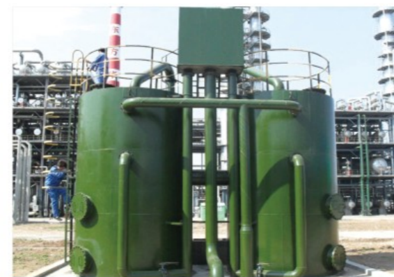
重力无阀滤池
