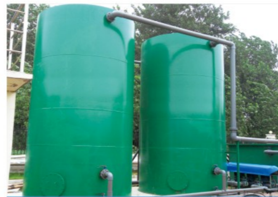
铁碳微电解塔
