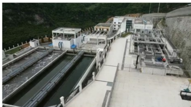
贵州正安县石梁河污水处理厂工程
